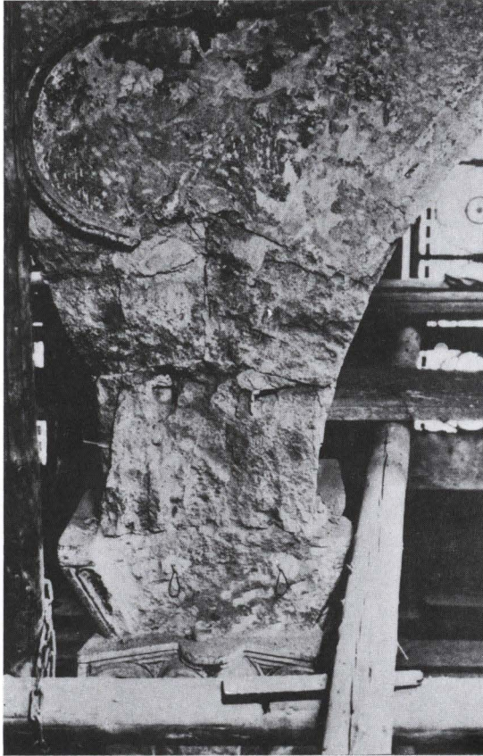
Abb. 51: Schäden an Arkade und Kämpfer der Südseite, 1930
