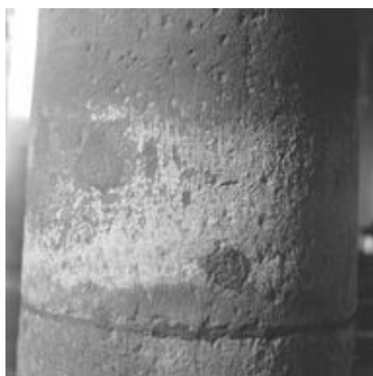
Salzausblühungen an den Säulen
