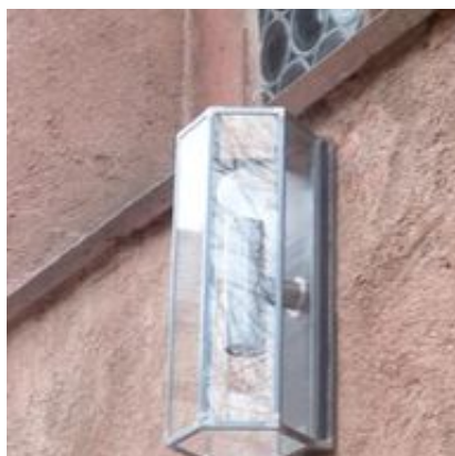
_ Neue, moderne Außenlampe
